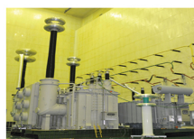
750kV交流变压器 750kV AC transformer
