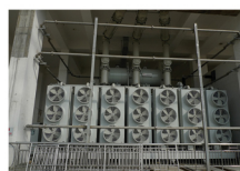
500kV交流变压器 500kV AC transformer
